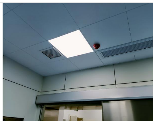
机房内排风口
